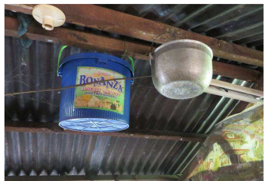
Das Wellblechdach ist löchrig...
